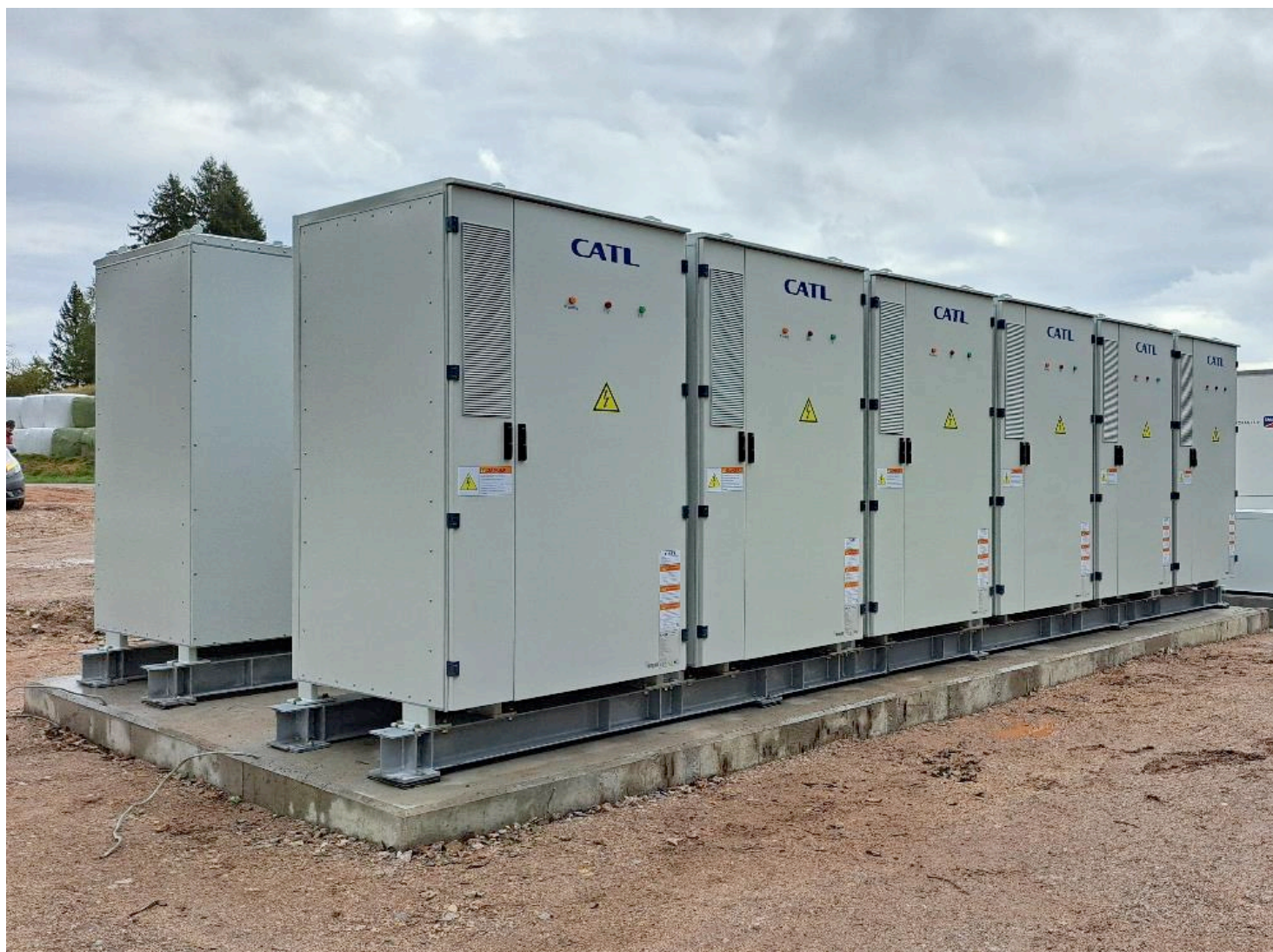
Figur 6. Batterimoduler monterade på stålbalkar ovanpå fundament. Källa: EnBW AG.
